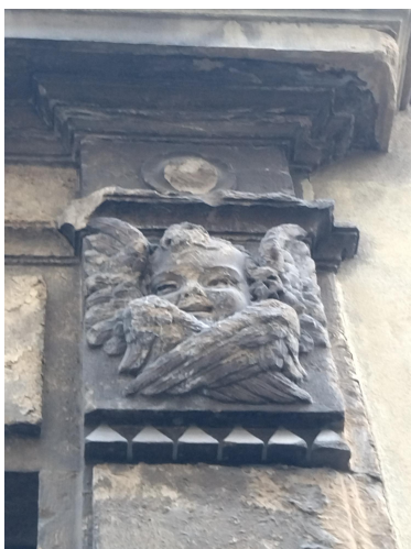
Part.fenomeni di degrado altorilievo angelo cherubino parete F lato strada
