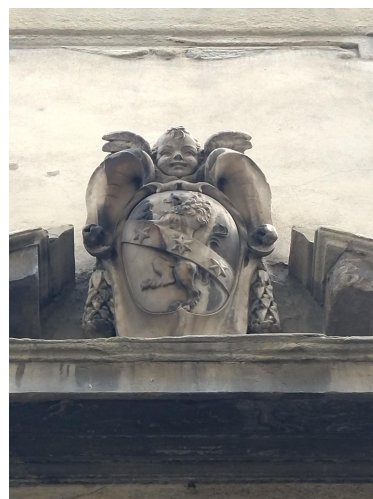
Part.fenomeni di degrado stemma marmoreo lato strada
